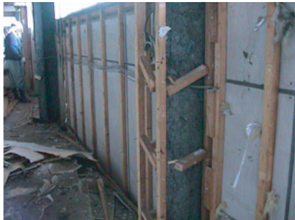
柱枠の木の下に現れた吹きつけ石綿 (上記 2 枚写真：ASBESTOS CENTER のHPより)
